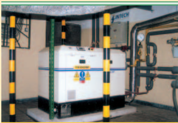
Kogeneračná jednotka v kotolni na ulici Obrancov mieru
