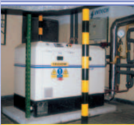
Kogeneračná jednotka v Dolnom Kubíne
